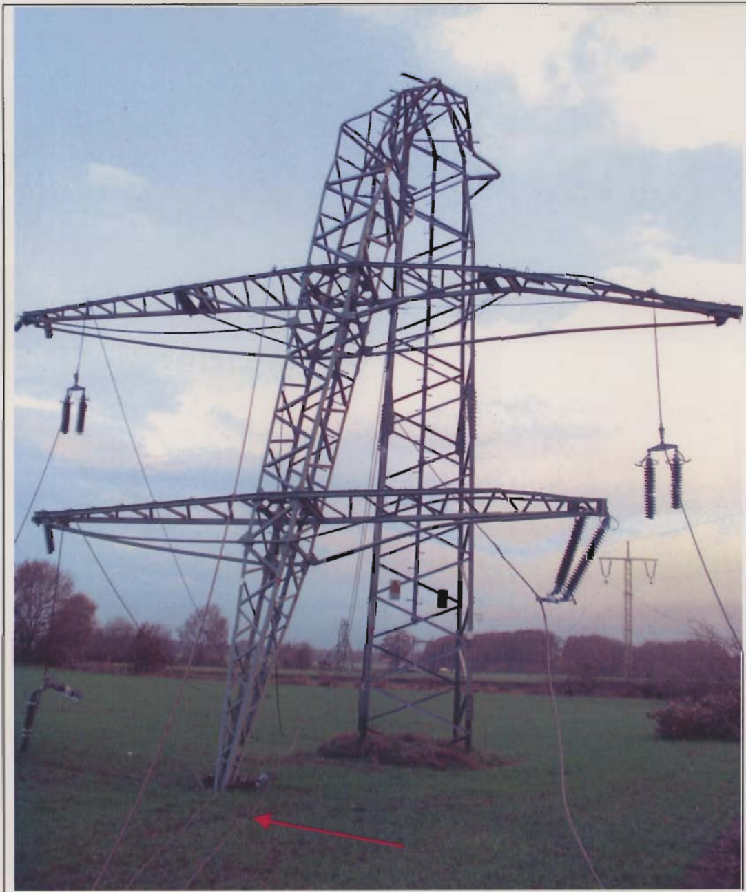
Bild 32: Freileitung 1503, Mast 70, Ansicht von Süd. Die Seile liegen alle auf der Westseite des Masts.
