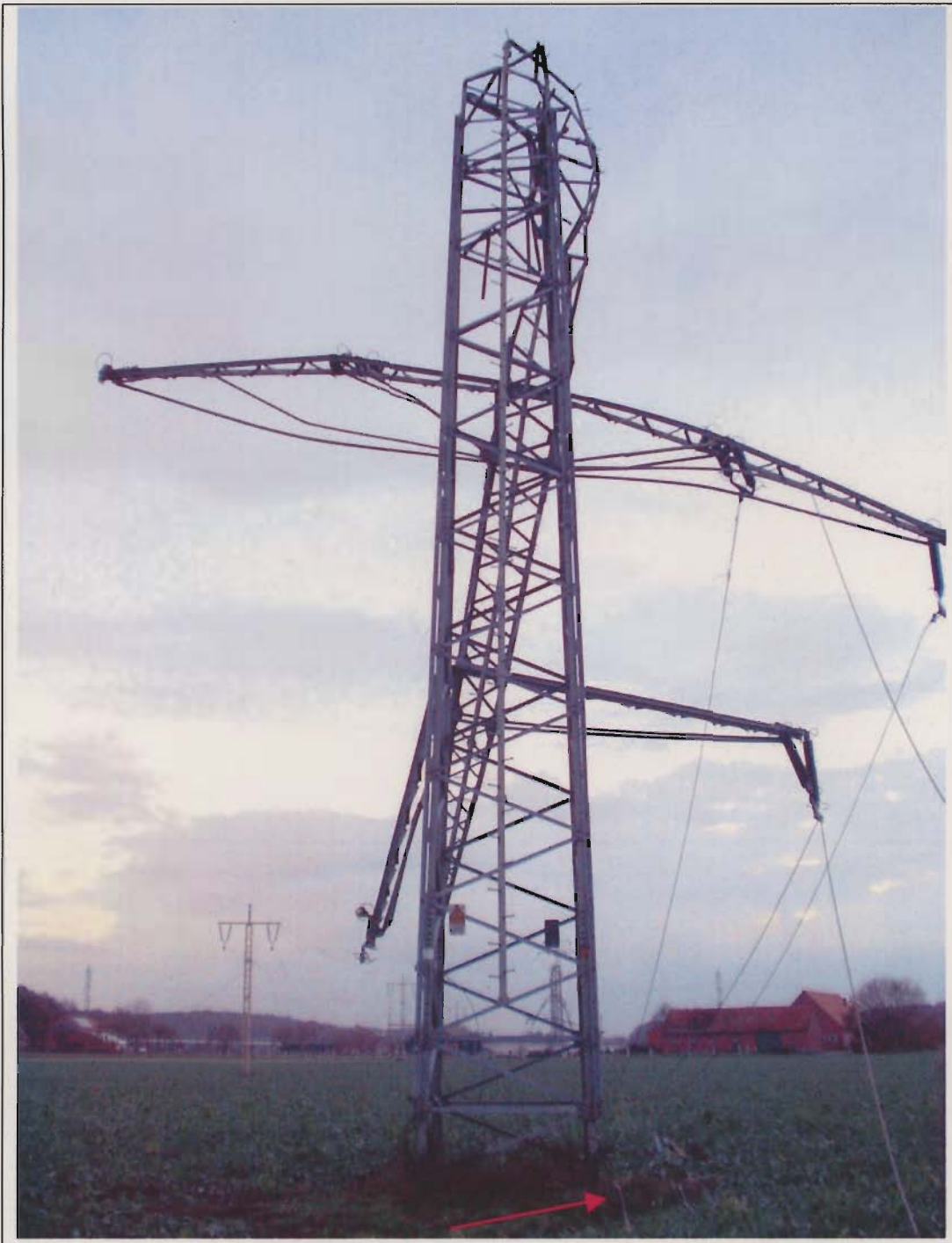
Bild 33: Freileitung 1503, Mast 72, Ansicht von Nord. Die Seile liegen alle auf der Westseite des Masts.
