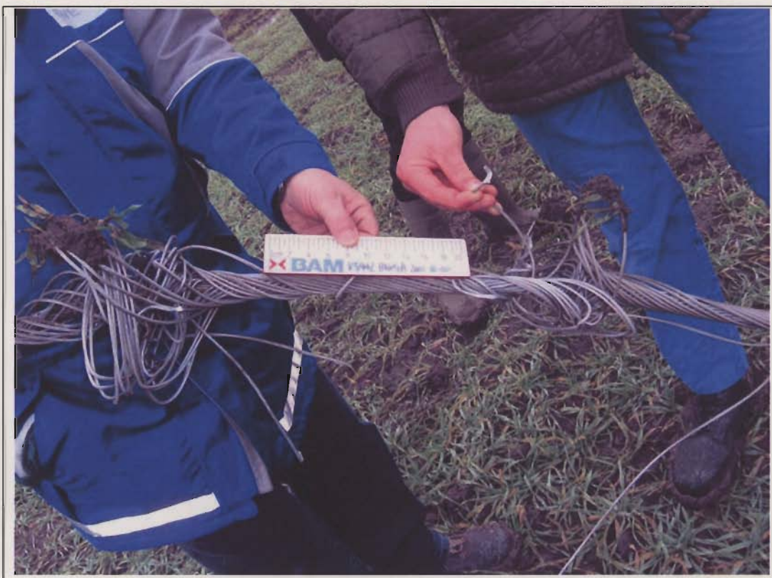
Bild 7: 1503Mast66, 2005-12-20, Seil aufgekorb, Drahtbrüche
