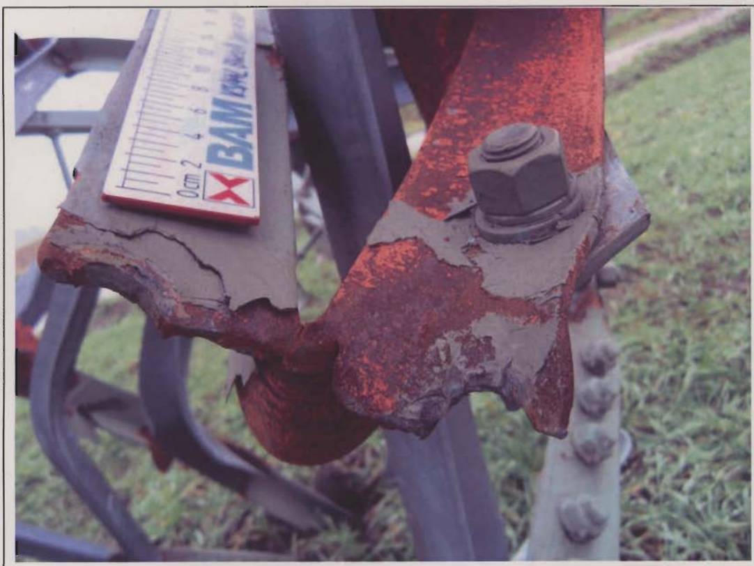
Bild 8: 1503Mast66, 2005-12-20, Diagonalenverschraubung ausgerissen
