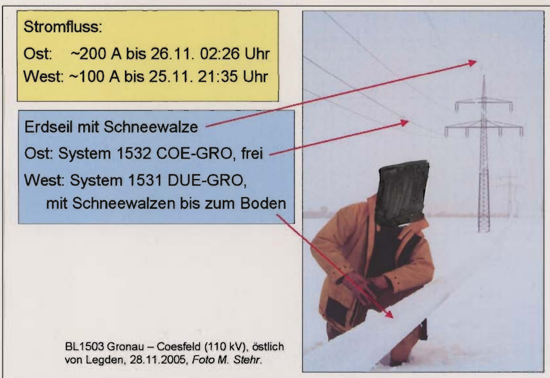
Bild 48: Betriebsführung der BL1503. Gegenüberstellung der mittleren Belastung der Teilsysteme 1531 und 1532 im Zeitraum des Schadensereignisses und der Schneebelegung der Teilsysteme am Mast 83 (vgl. Bild 39).
