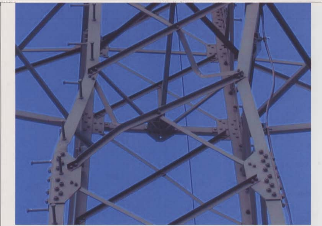
Bild 14: 1525Mast 22, Diagonalen geknickt, Bruch einer Diagonale nicht erkennbar: Primärversagen Stabilitätsversagen durch Knickung
