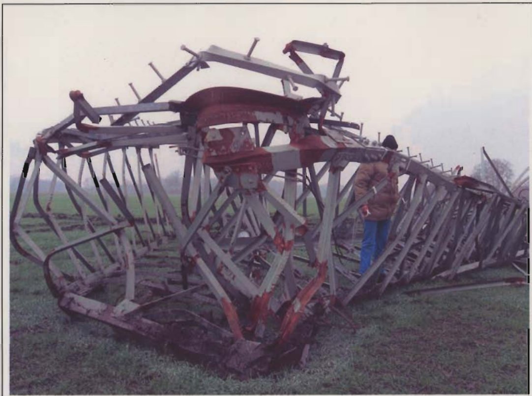
Bild 1: 1503Mast65, 2005-12-20, Dokumentation, Suche nach Bruchstellen
