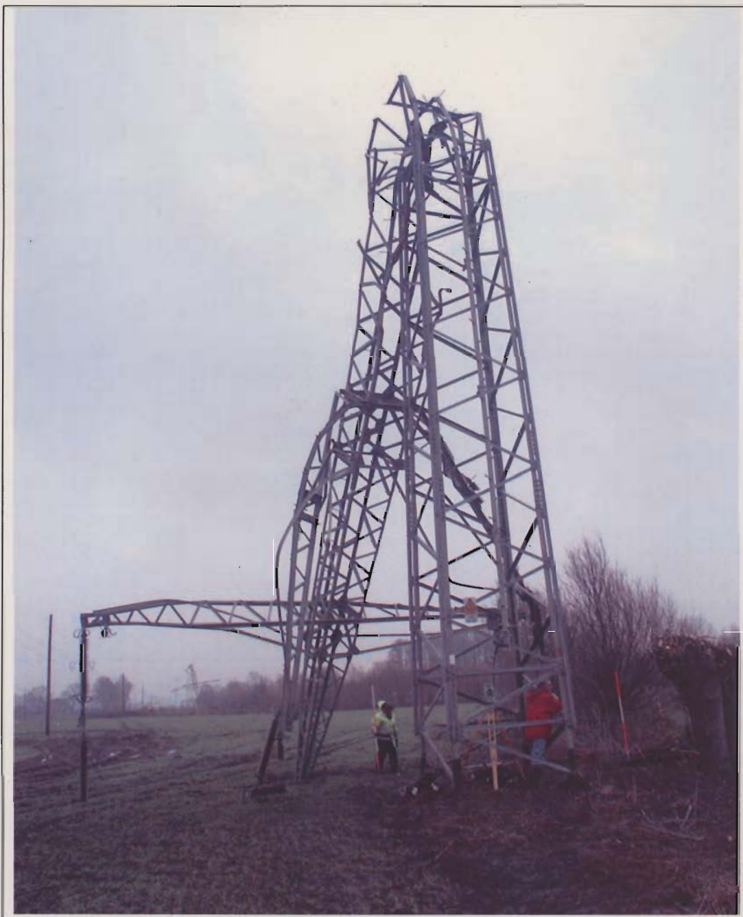
Bild 10: 1503Mast69, 2005-12-20, stehend, Blick in Freileitungsrichtung SO, M70 im Hintergrund
