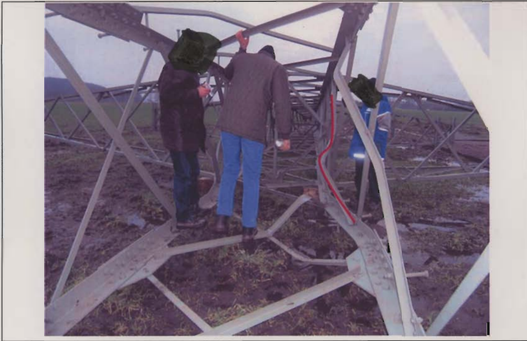
Bild 15: 1525Mast 22, 2005-12-20, mehrere Diagonalen in der 2. Eigenform geknickt, Primärversagen Stabilitätsversagen, Auswahl und Kennzeichnung der Prüfstücke
