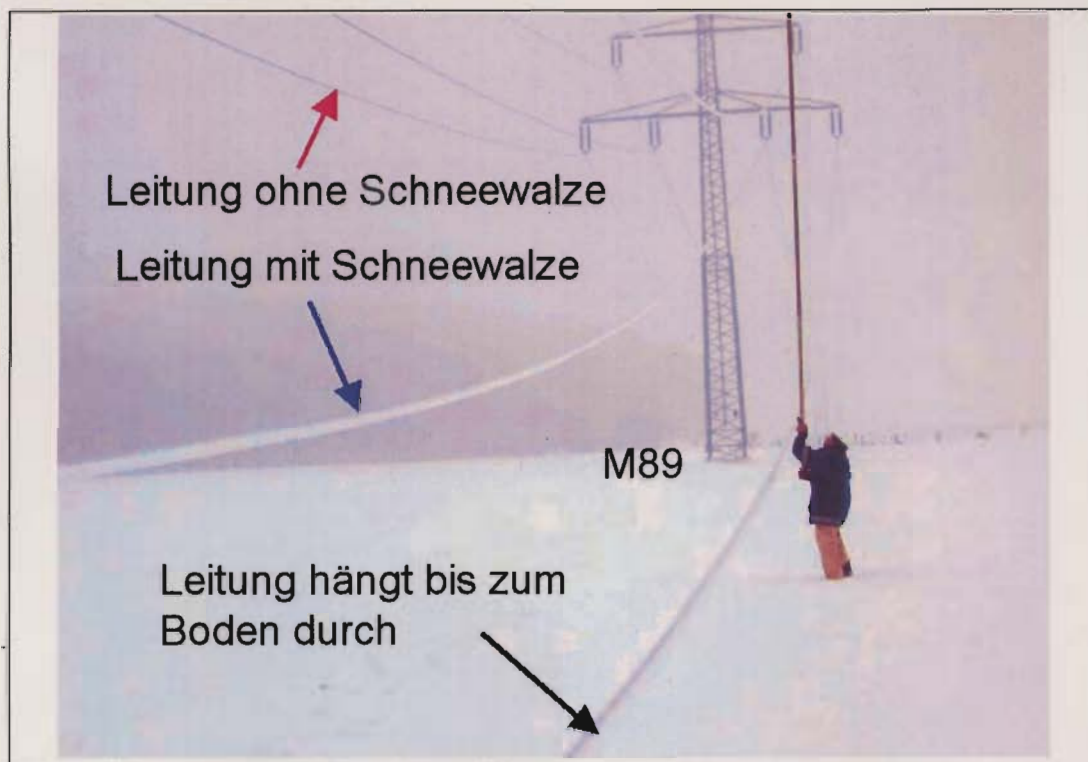
Bild 40: Freileitung 1503, Mast 89, aus Screencopy aus Gutachten Thierauf (Bild 18, nachbearbeitet und mit Bezeichnungen versehen). Blick Richtung Südost.
